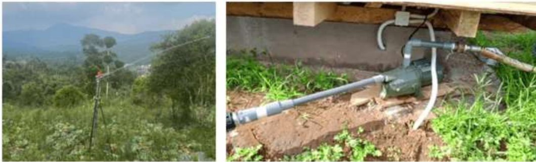
Gambar 8. Desain dan Pemasangan Smart Watering dengan Energi Terbarukan
